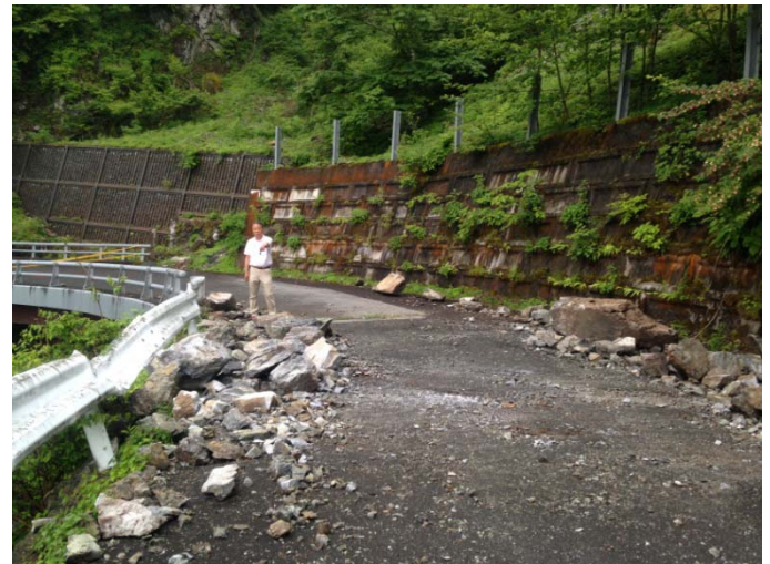
2016.06.08 コース上の落石現場
