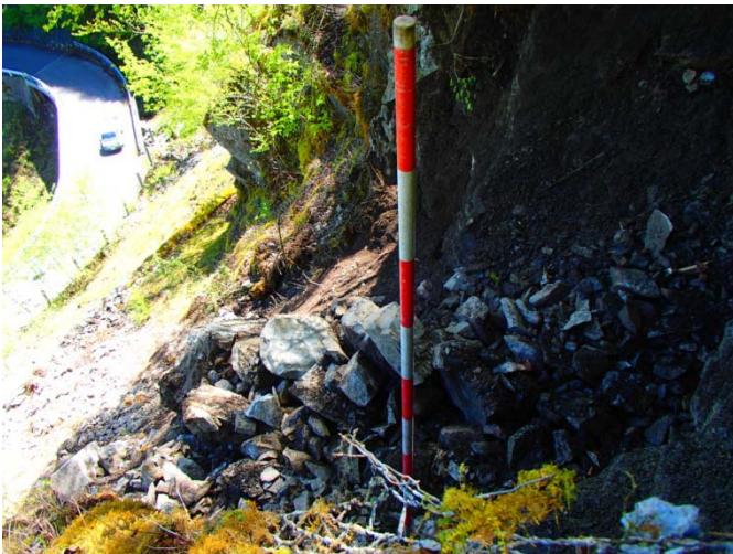
落石現場の崖上
